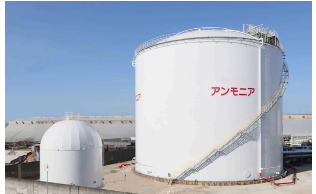
石井鉄工所が23年に化学大手に納入した国内最大規模のアンモニア貯蔵タンク
