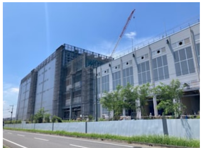
米ブラックストーンが日本で開発するデータセンター（写真は24年）
