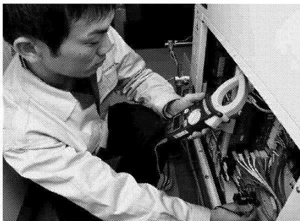
エンジニアが機器の稼働状況の検証を代行する
