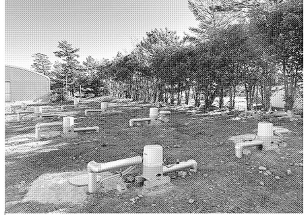
静岡県袋井市の工場に地中熱利用システムを導入した
