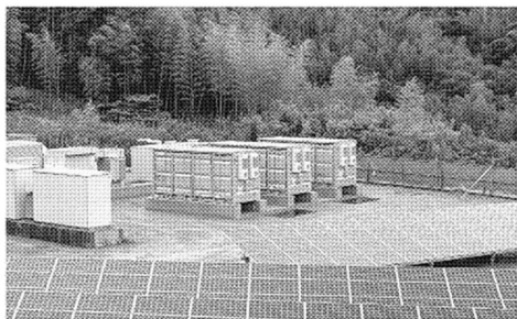
三井住友ファイナンス&リースは太陽光発電所に蓄電所を併設する(福岡県古賀市)
